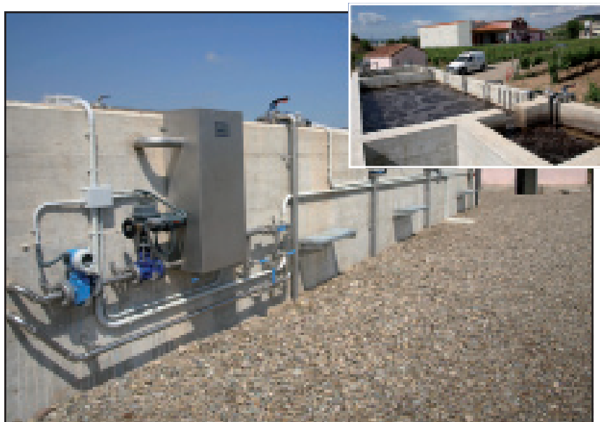
Figura 10. Sistema MBR en la EDAR de Bodegas Viña Ijalba.
