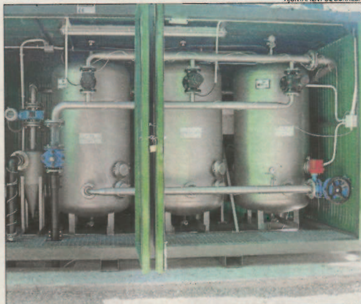
Planta potabilitzadora que ha entrat en servei a Borredà
